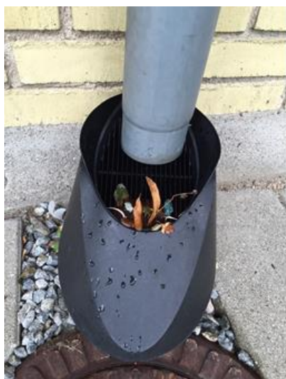
Figur 5.2. En regnvandsventil skal efterses, og blade skal fjernes, så tagvandet ikke utilsigtet løber ud på overfladen
