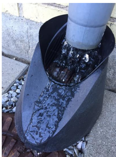
Figur 5.3. I frostvejr kan der dannes is i regnvandsventilen
